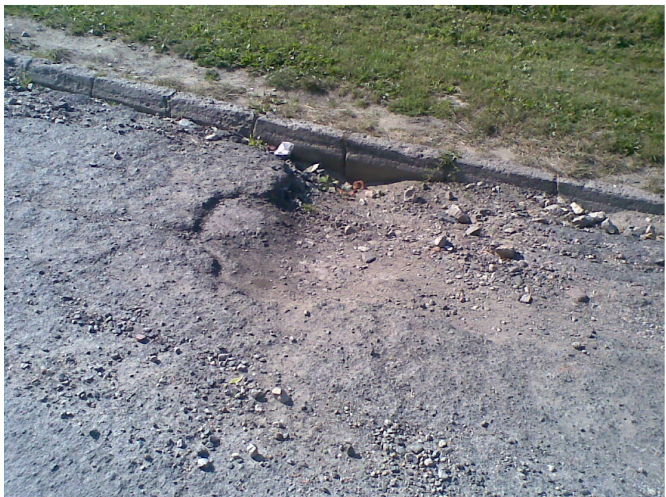
Zdjęcie nr 2 . Widok zniszczony krawężnik betonowy
