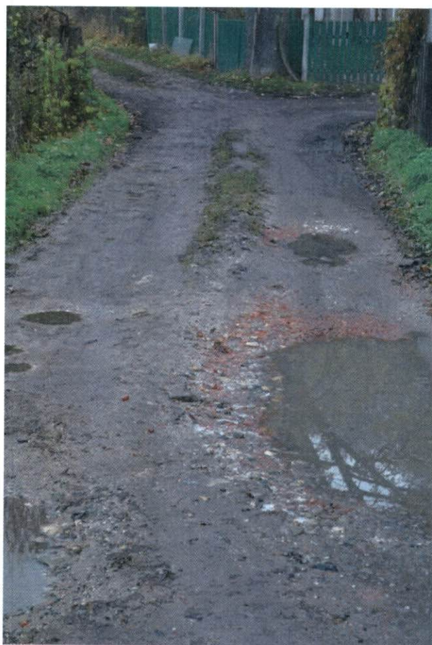
Rysunek 16 Stan nawierzchni ul. Sosnowej
